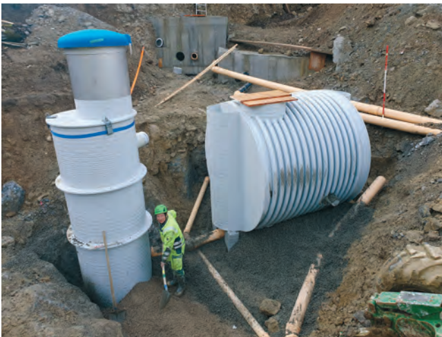
Im Steintal wurden die drei Stöfeli-Quellen neu gefasst und in den neuen Quellsammelschacht geführt (rechts im Bild). Links ist der siphonierte Überlaufschacht. Die Arbeiten gestalteten sich aus verschiedenen Gründen sehr aufwendig.
